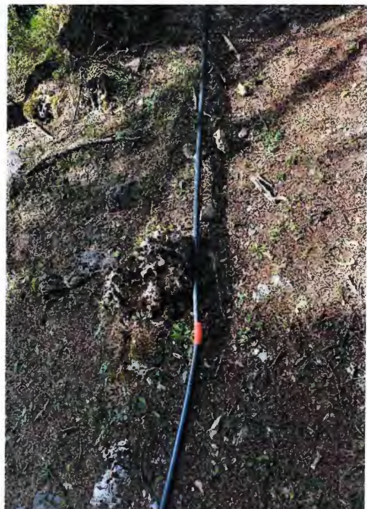
Figure 4 : Tuyau de raccordement illégal qui a été sectionné une première fois par la REAAM et qui a été recollé par la personne mettant en eau les abreuvoirs illégalement
