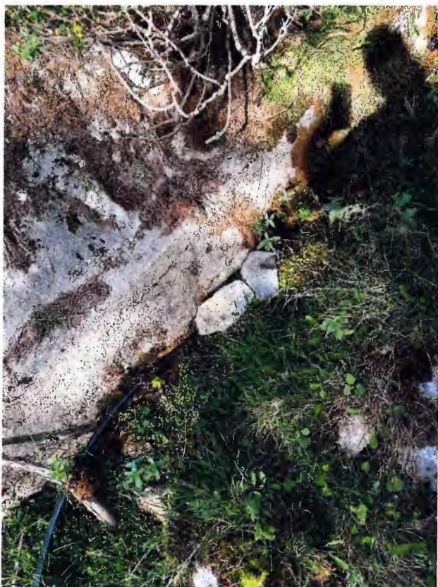
Figure 5 : Endroit de raccordement du branchement illégal (en dessous du captage Font de l'Oule, sur un trop plein d'eau
