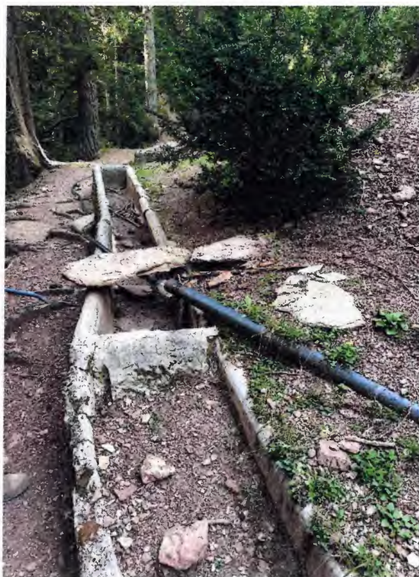
Figure 6 : Ancien branchement illégal qui servait à alimenter les abreuvoirs, ultérieurement branché à la chambre de réunion des captages.
